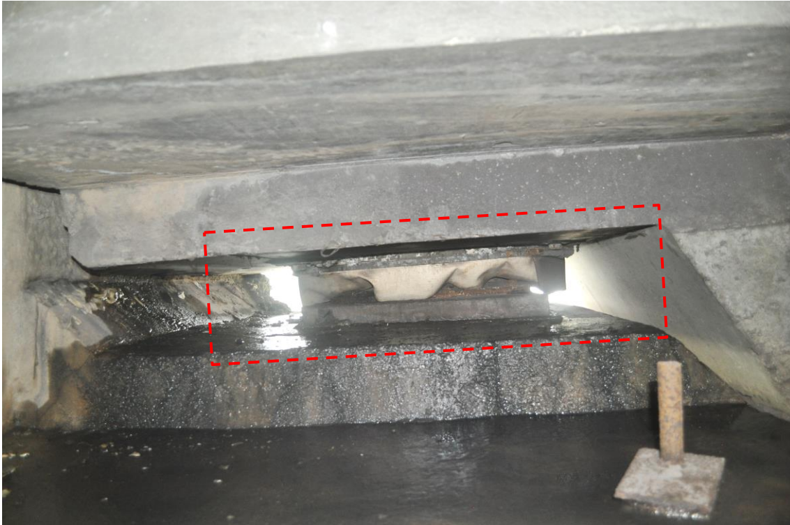
Figura 11 – Aparelhos de apoio com sinais de funcionamento normal
