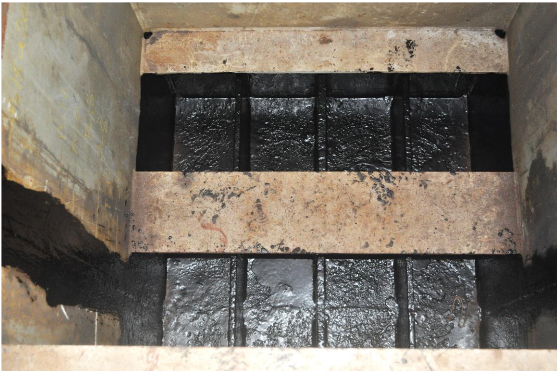
Figura 16 - Aplicação de pintura com alcatrão visando a proteção da estrutura metálica contra corrosão
