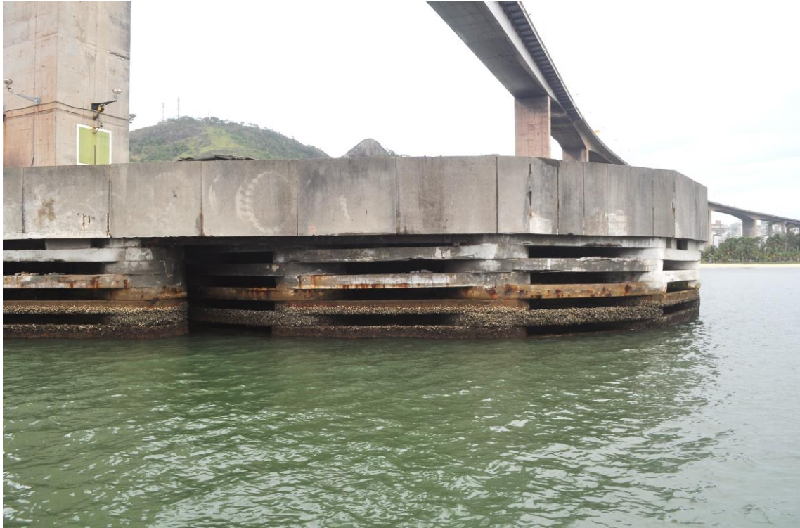
Figura 3 – Estado de conservação das defensas
